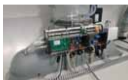
3 Abluftsammelkanal mit Stellglied, Messeinrichtung und Messwertfassung
